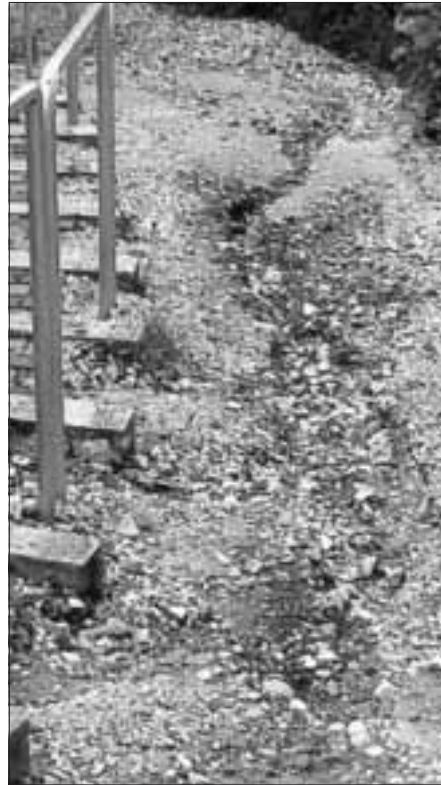
Ausschwemmungen nach Starkregen
